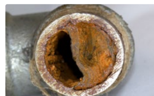
Tuyau présentant des dépôts de calcaire
