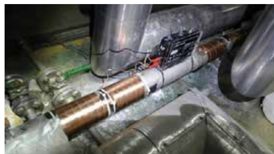
Vulcan S25 installé chez Toray Industries
