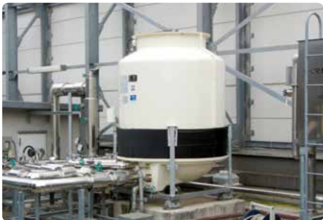
Tour de refroidissement
