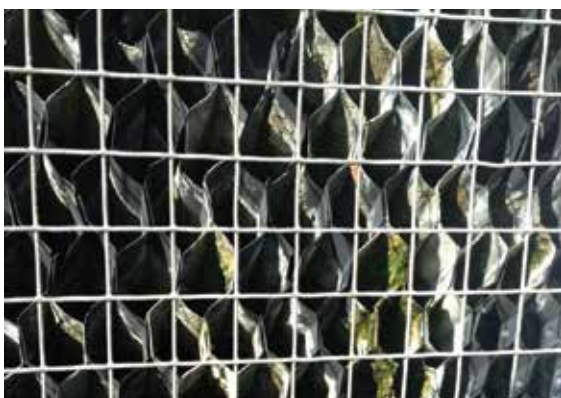
La photo ci-dessus a été prise sur la CT-1 environ 3 semaines après l'installation de Vulcan.
