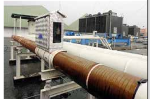
Vulcan S500 se trouvait dans un boîtier en aluminium installé sur l'une des conduites principales de la tour de refroidissement dans Supermal Karawaci.
