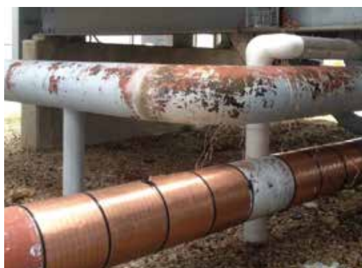
Vulcan S250 a été installé sur une ligne de 10 pouces de diamètre servant à alimenter les deux tours de refroidissement (CT-1 et CT-2)
