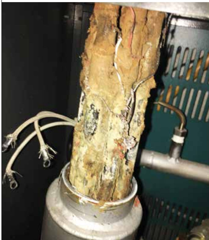
Échangeur de chaleur non traité pendant 3 ans.
