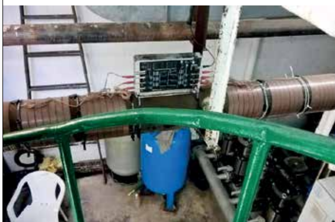
2 Vulcan S100 ont été installés.
