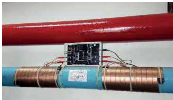
Le dispositif anti-calcaire électronique Vulcan S25 installé
