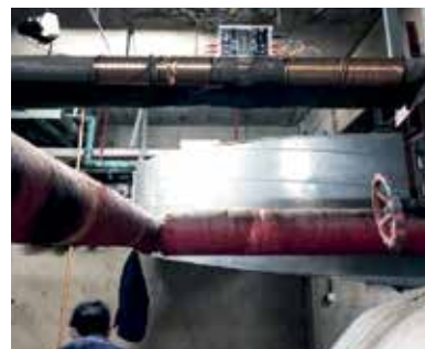
Vulcan S25 a été installé sur une conduite en cuivre DN80.
