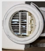
Filtre de piscine
