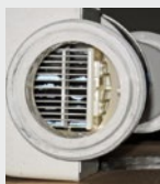
Filtere de piscine
