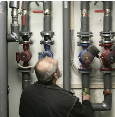
Canalisations dans un immeuble
