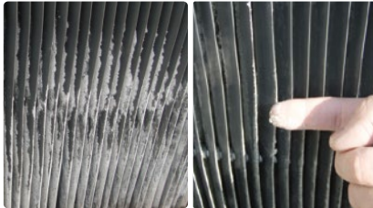
Grille d'une tour de refroidissement
