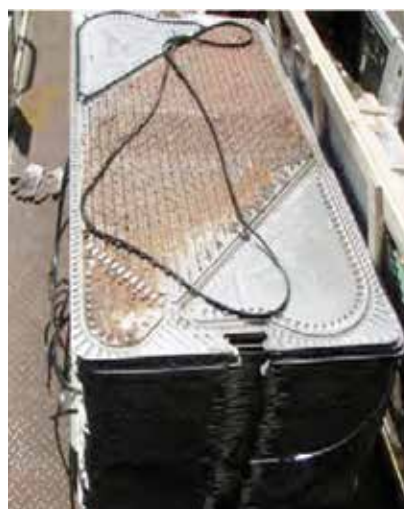
9 mois après l'installation de Vulcan : l'échangeur à plaques démonté pour être nettoyé.
