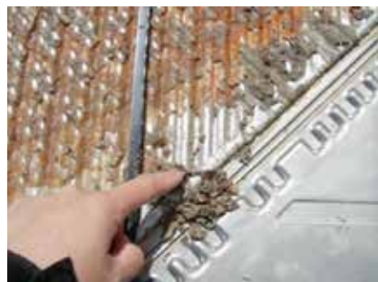
Le calcaire présent sur l'échangeur à plaques devient malléable.
