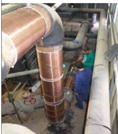
Vulcan S500 a été installé dans la station d'échange thermique.
