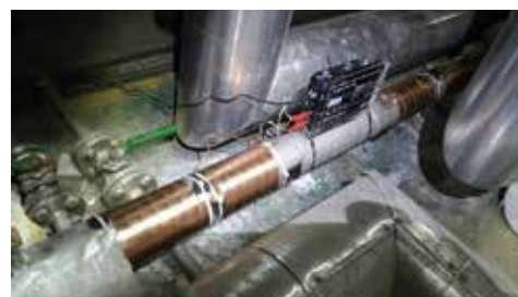
Vulcan S25 installé chez Toray Industries
