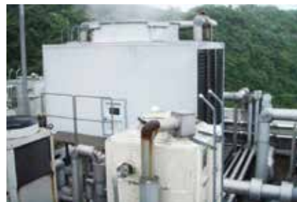
Le toit de la tour de refroidissement de l'entreprise pharmaceutique
