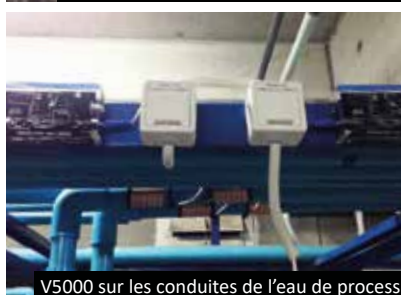
V5000 sur les conduites de l'eau de process
