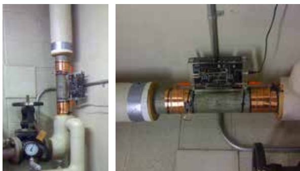
Installation du détartrant Vulkan au niveau de l'alimentation générale en eaux des bâtiments de l'école Roosevelt
