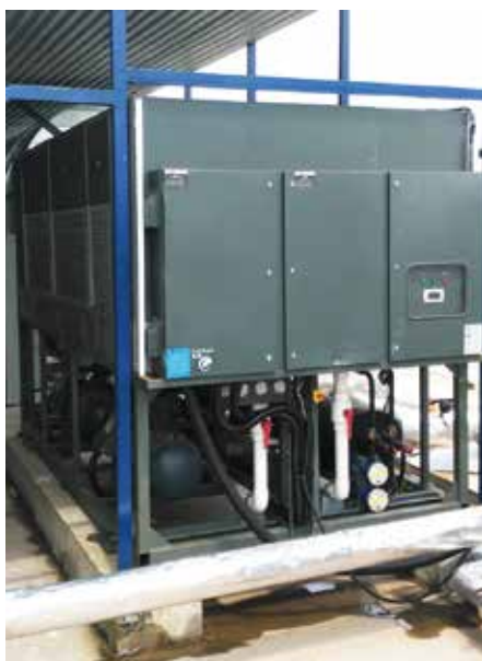
Dispositif principal de climatisation
