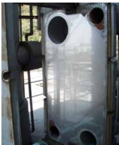
9 mois après l'installation de Vulcan : l'échangeur à plaques est propre et prêt à l'emploi.
