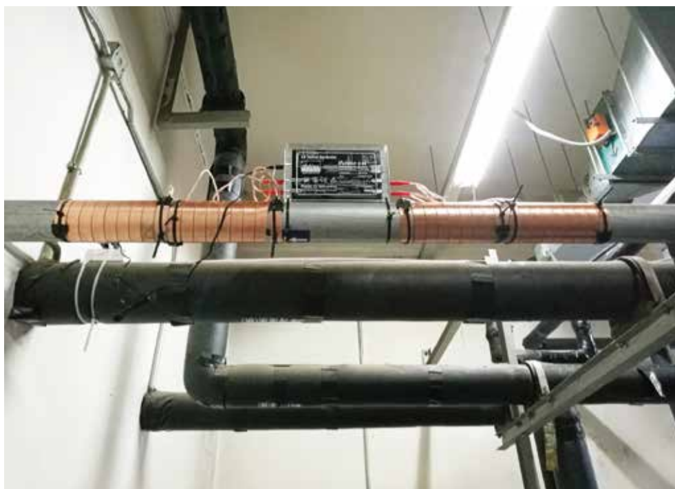
Vulcan S25 a été installé sur la conduite d'eau principale de la tour de refroidissement.
