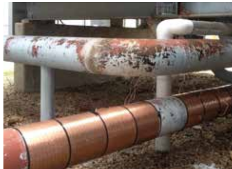
Vulcan S250 a été installé sur une ligne de 10 pouces de diamètre servant à alimenter les deux tours de refroidissement (CT-1 et CT-2)
