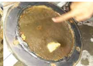
À l'intérieur de l'échangeur thermique. La plaque d'extrémité du condensateur s'est débarrassée du calcaire autrefois présent. (La légère tâche en bas représente la réflexion de la lumière.)
