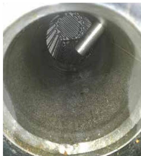
3 mois après – avec le traitement Vulcan Jusqu'à présent, la conduite installée n'a plus eu besoin d'être nettoyée.
