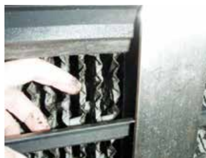
5 mois après l'installation de Vulcan : le calcaire s'enlève facilement à la main.
