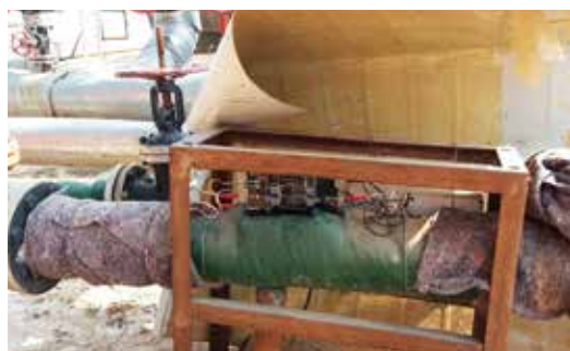
Avant d'installer Vulcan, la rouille et l'isolation des tuyaux ont été enlevées, et les bandes d'impulsion ont été enroulées sur le tuyau. Ensuite, l'isolation extérieure a été remise en place.
