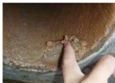
Le calcaire présent dans le conduit de circulation s'enlève également facilement à la main.
