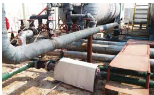
Installation à l'extérieur avec couvercle fait maison, pour protéger l'appareil du vent et du soleil.
