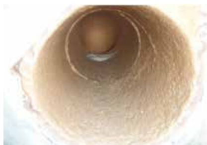
Conduit de circulation
