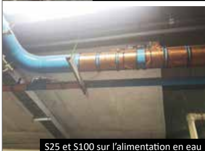
S25 et S100 sur l'alimentation en eau
