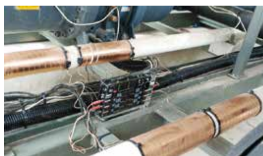
Vulcan S100 a été installé sur le dispositif principal de climatisation
