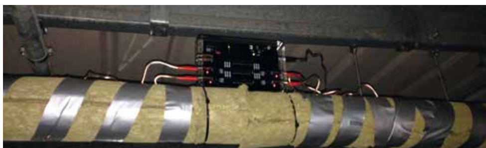
Unité Vulcan S25 installé avec isolation enveloppé dans les tuyaux
