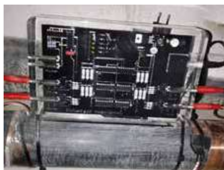
Vulcan S25 installé dans la conduite principale d'eau pour 132 appartements
