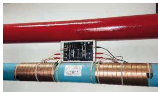
Le dispositif anti-calcaire électronique Vulcan S25 installé
