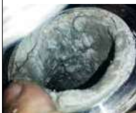
Avant l'installation de Vulcan : Le tuyau était recouvert de dépôts de calcaire.
