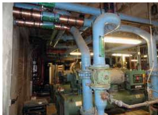
Unités Vulcan S100 installés sur le double refroidisseur
