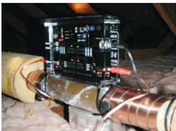
Vulcan S10 installée sur eau principale pour les dortoirs des logements Bodega
