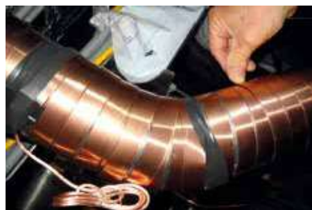
Câbles de Vulcan enroulés deux fois autour d'une conduite
