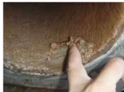
Le calcaire présent dans le conduit de circulation s'enlève également facilement à la main.
