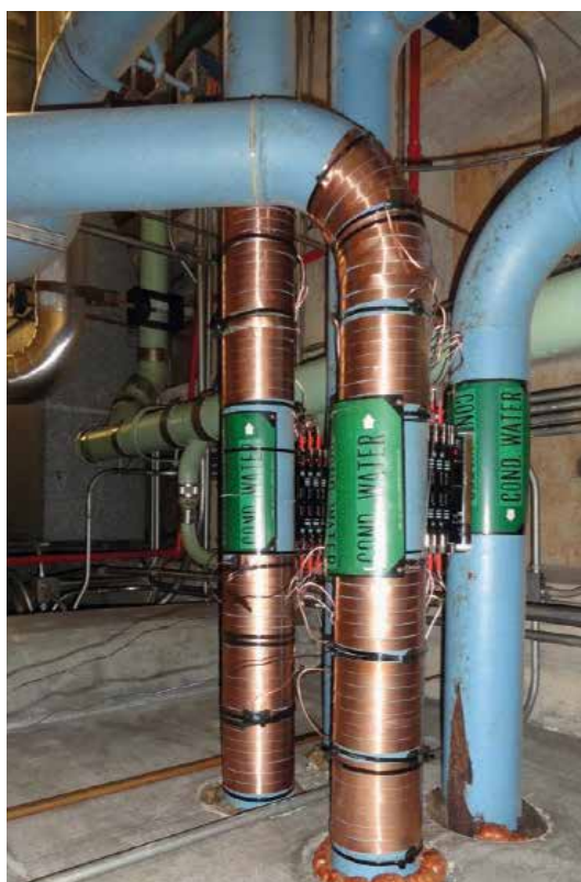
Unités Vulcan S100 installés sur le double refroidisseur
