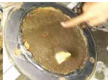
À l'intérieur de l'échangeur thermique. La plaque d'extrémité du condensateur s'est débarrassée du calcaire autrefois présent. (La légère tâche en bas représente la réflexion de la lumière.)
