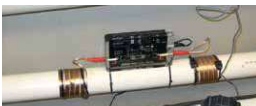
Vulcan 5000 sur la ligne de skimmer de la piscine principale
