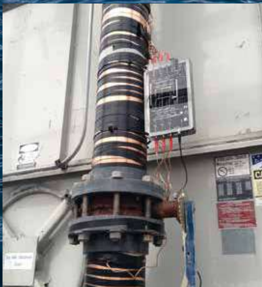
Vulcan S100 installé sur les tours de refroidissement
