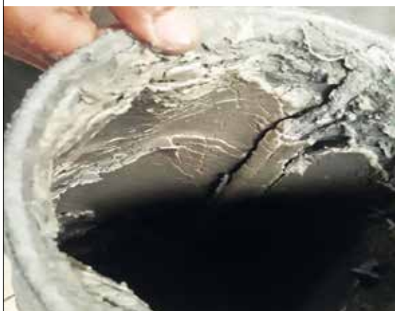
Sans Vulcan, le filtre était rapidement obstrué par les dépôts de calcaire et il devait être remplacé toutes les 48 heures.
