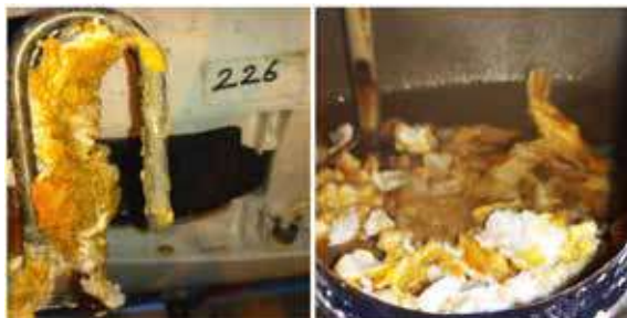
Photos 2 et 3. Le calcaire enveloppant autrefois l'élément chauffant et le réservoir de puisard. (photos prises dans l'une des chambres de l'hôtel IBMA)
