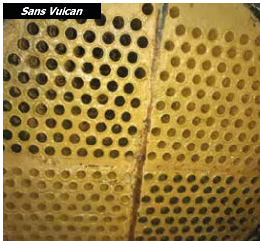
Avant d'installer Vulcan, le calcaire était très épais et dur au niveau des tubes de l'échangeur de chaleur.
