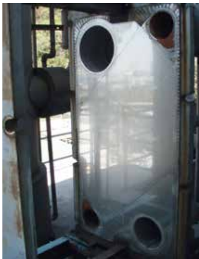
9 mois après l'installation de Vulcan : l'échangeur à plaques est propre et prêt à l'emploi.
