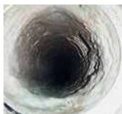
2 semaines après l'installation de Vulcan, le calcaire s'est amolli et est tombé.
