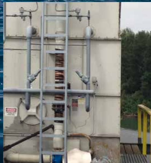
Vulcan S100 installé à l'extérieur
