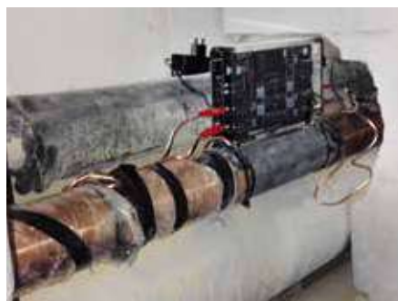
Vulcan S25 installé dans la conduite principale d'eau pour 132 appartements
