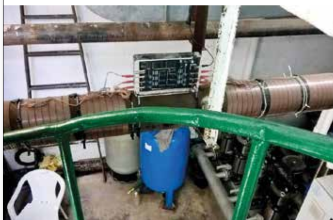
2 Vulcan S100 ont été installés.
